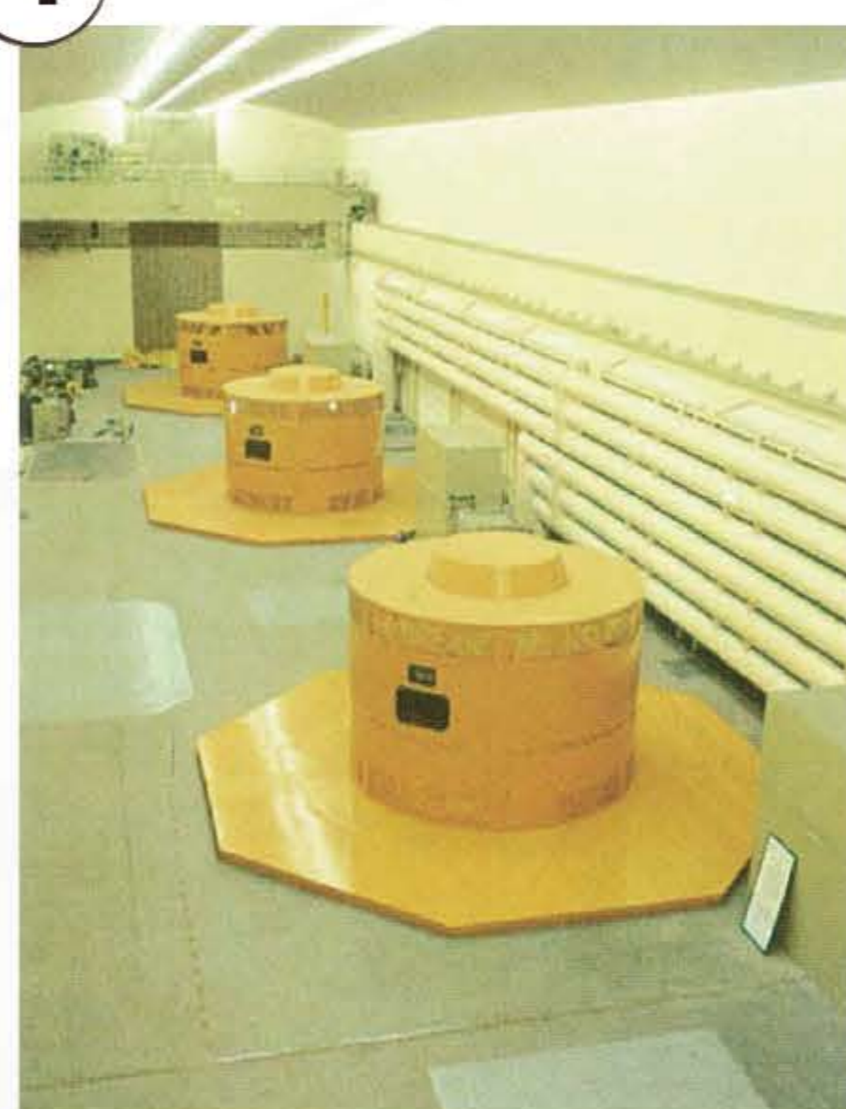
4 奥矢作第二発電所(地下式)
